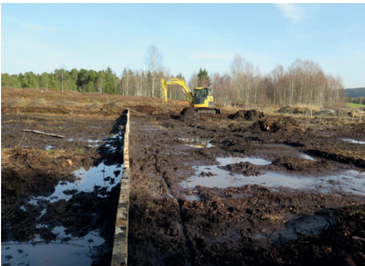
← Comblement des fosses d'extraction, La Tourbière de «Sur les Seignes» à Frambouhans et Les Ecorces (25) Source : Life Tourbières Jura
